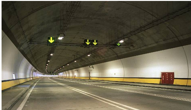
(圖 4-20 車道管制號誌)
